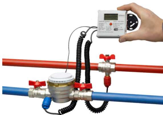
Рисунок 5 – Пример установки счетчиков тепла CF-UltraMaXX
