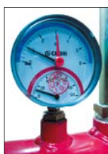
Термоманометр на выходе котла
