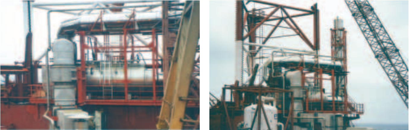
Рис. 7.5. Пример энергетической установки, состоящей из газовой турбины и парового котла-утилизатора серии Vitomax 200 HS АНК
